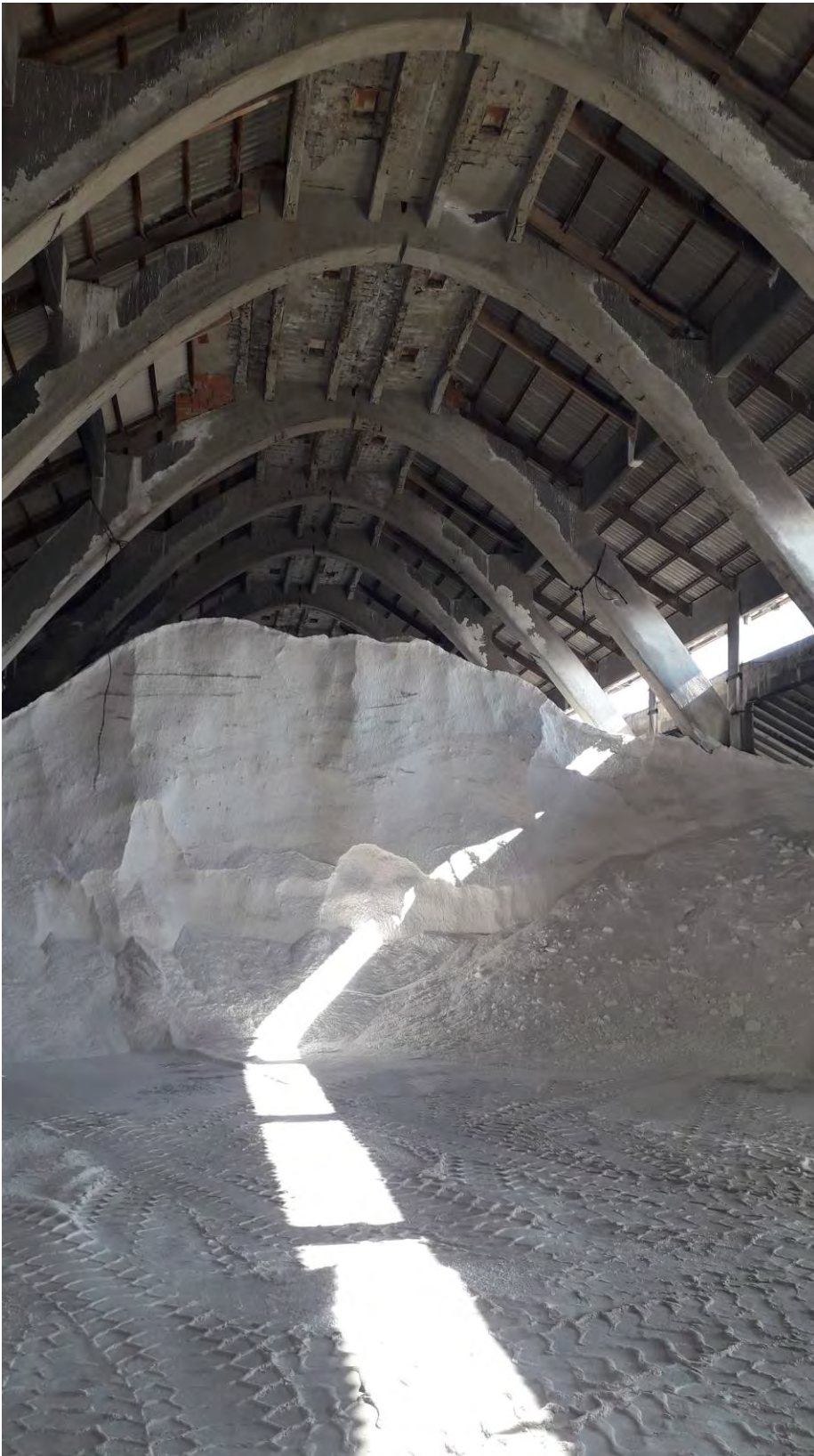
Fig.06 – Foto dell'interno del manufatto con deposito del sale (Antonio Rioldino 2019)
