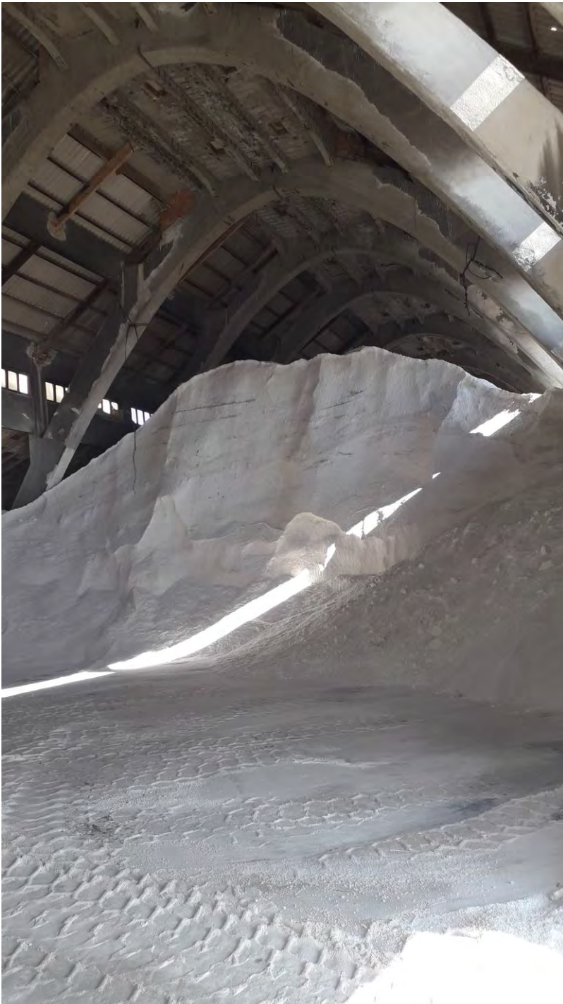
Fig.05 – Foto dell'interno del manufatto con deposito del sale (Antonio Riondino 2019)
