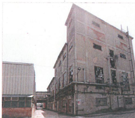
- veduta fronte ovest edificio a più piani individuato in pianta con il n° 5 -
